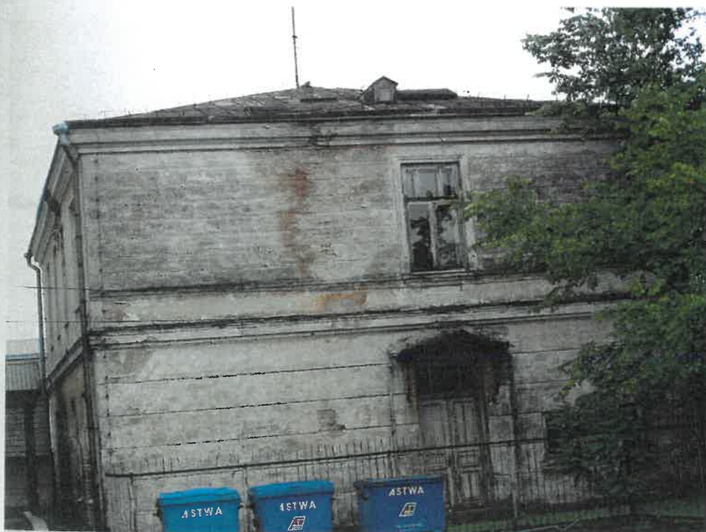
Elewacja wschodnia- skorodowane pokrycie dachowe, korozja biologiczna ściany od przecieków z dachu.
