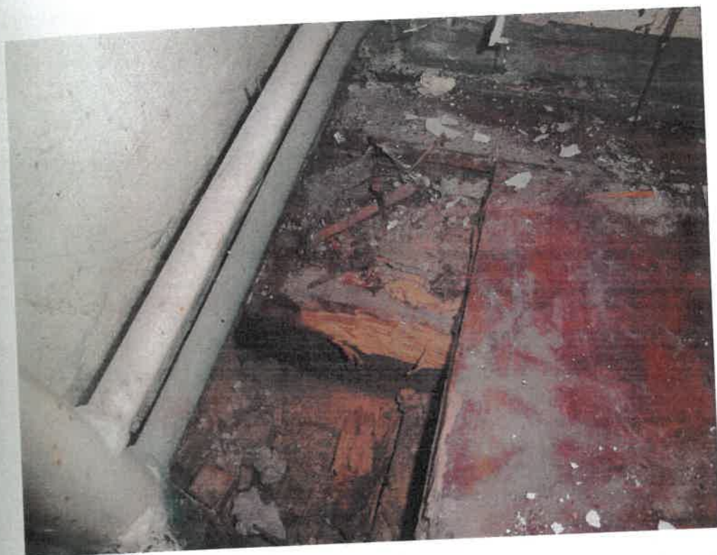
Odkrywka stropu w pomieszczeniu nr 11- korozja biologiczna belek stropowych desek podłogowych (strop nad parterem).
