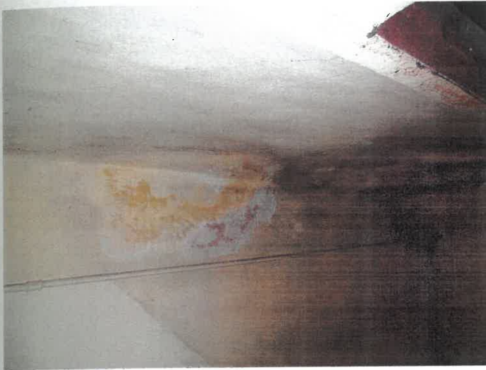
Korozja stropu ceramicznego nad klatką schodową.
