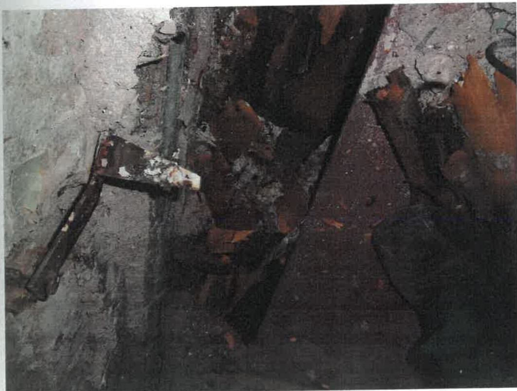
Odkrywka stropu parteru w pomieszczeniu nr 4- zgniłe zagrzybione deski podłogowe i legary, porażone przez owady, widoczny rozległy grzyb domowy biały.
