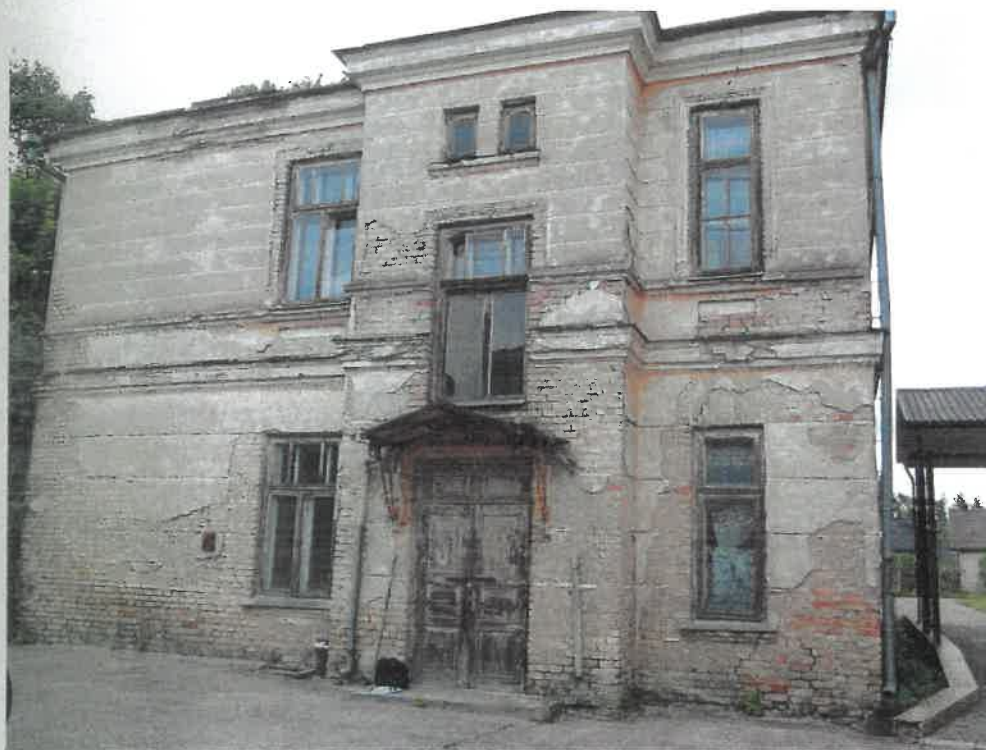
Elewacja frontowa, widoczne pęknięcie ściany podokiennej, przyległy teren powyżej poziomu posadzki parteru.
