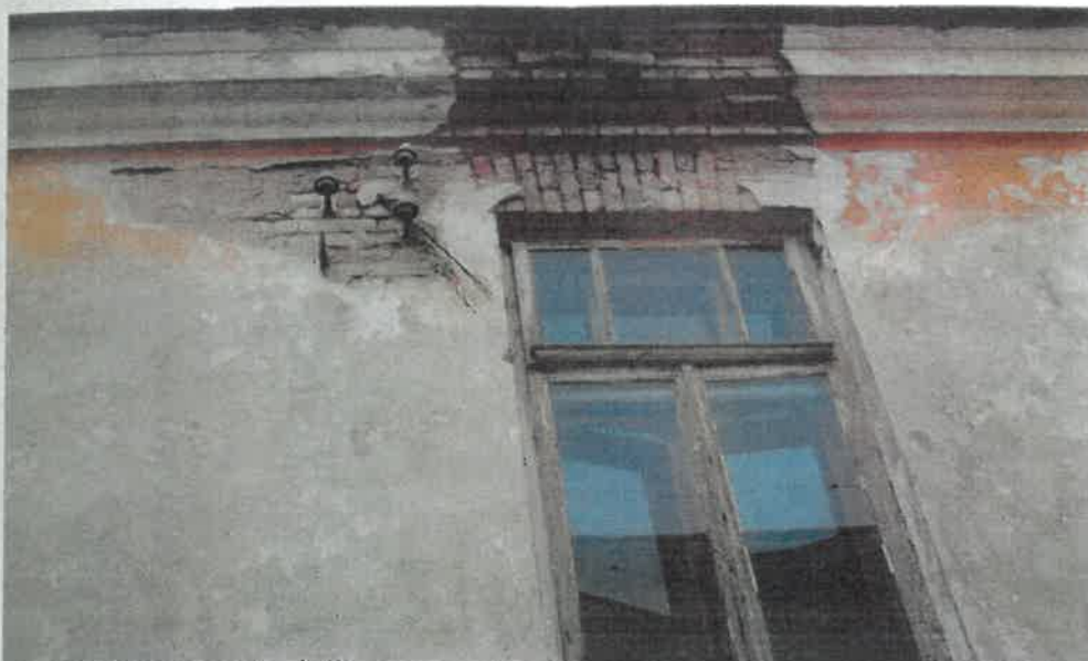
Ubytki cegły gzymsu, widoczne cegły, które w każdej chwili mogą wysunąć się z gzymsu, wymagają niezwłocznego zabezpieczenia (usunięcia).
