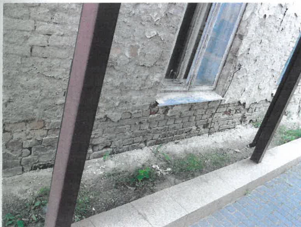
Elewacja od strony szpitala, widoczne pęknięcia i zagrzybienie ściany, przyległy teren powyżej poziomu posadzki parteru.
