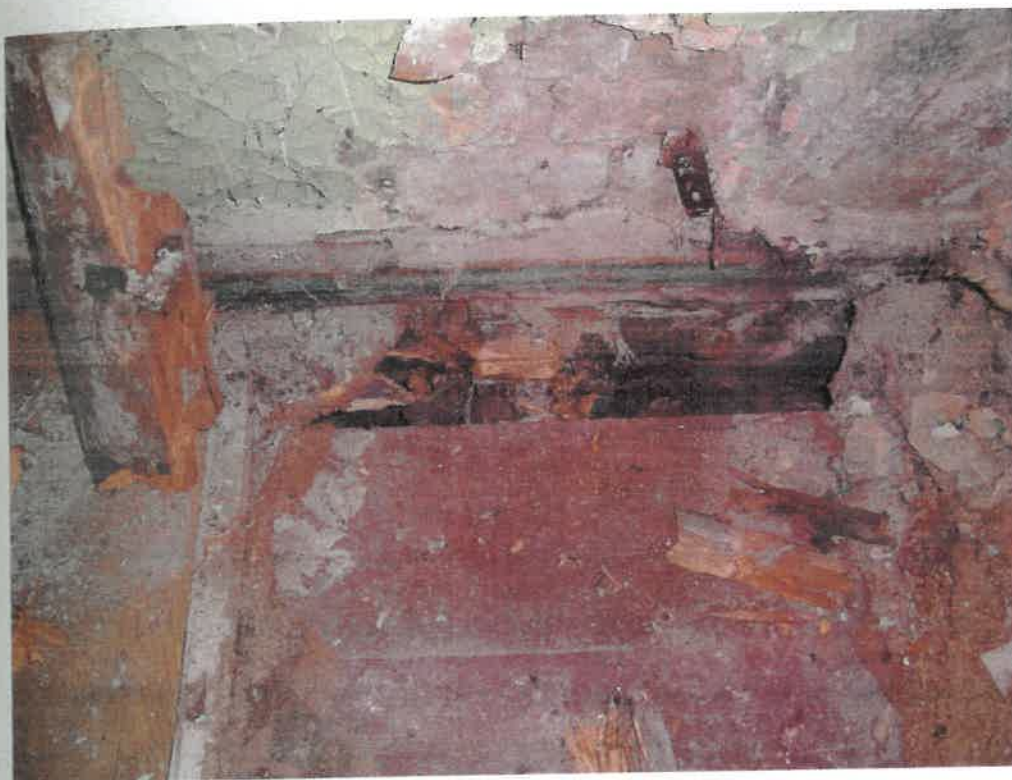
Odkrywka stropu pomieszczenia nr 4 zgnite i porażone przez grzyby elementy stropu.
