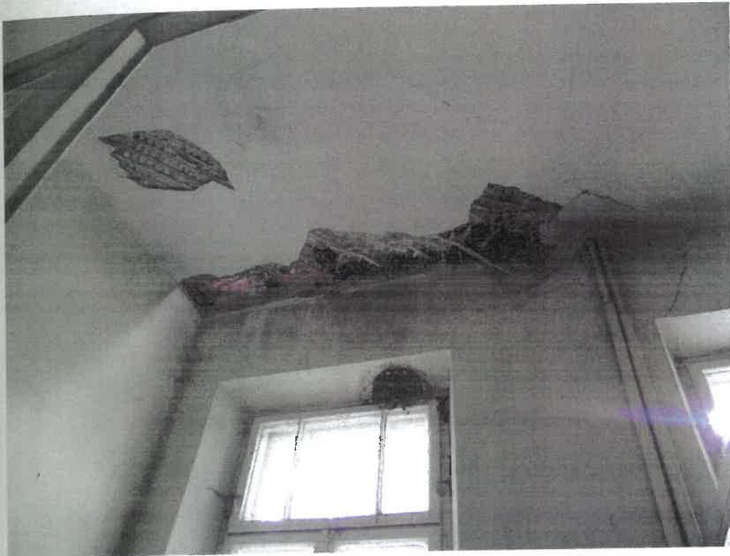
Pomieszczenie nr 8- korozja belek i stropu, skorodowane końce belek zakotwionych w ścianie- przeciek dachowy.
