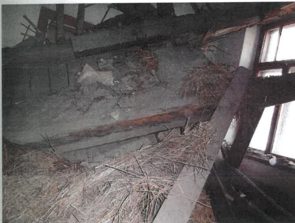
Fragmenty zawalonego stropu nad pomieszczeniem nr 10, widoczne wzmocnienie belki stropowej i korozja belek.
