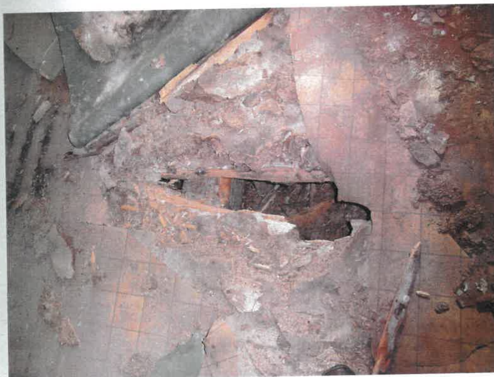
Odkrywka stropu parteru w pomieszczeniu nr 3- zgnite zagrzybione deski podłogowe, legary porażone przez owady i korozję biologiczną.
