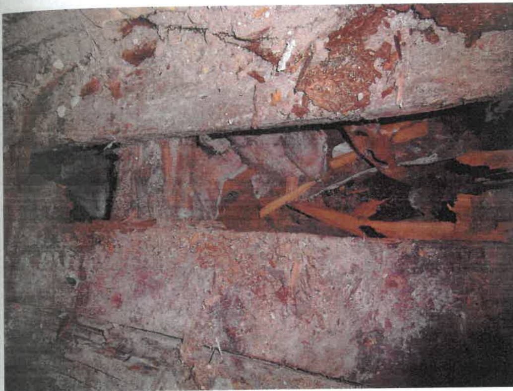
Odkrywka stropu parteru w pomieszczeniu nr 2- zgniłe zagrzybione deski podłogowe, legary porażone przez owady i korozję biologiczną, widoczny rozległy grzyb domowy biały.
