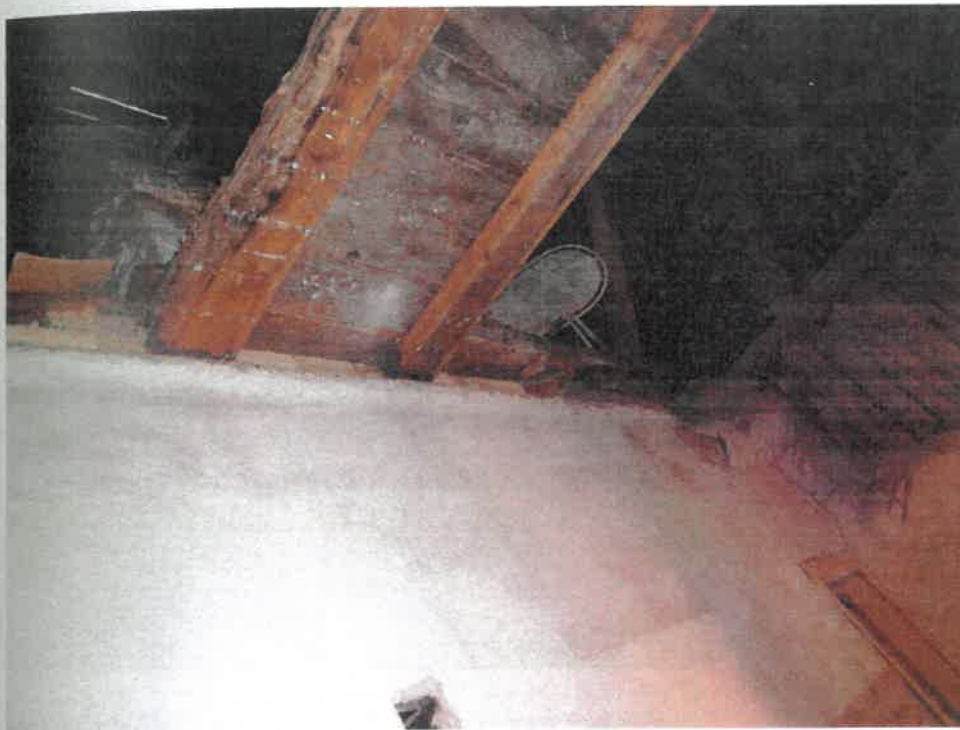
Fragmenty zawalonego stropu nad pomieszczeniem nr 10.
