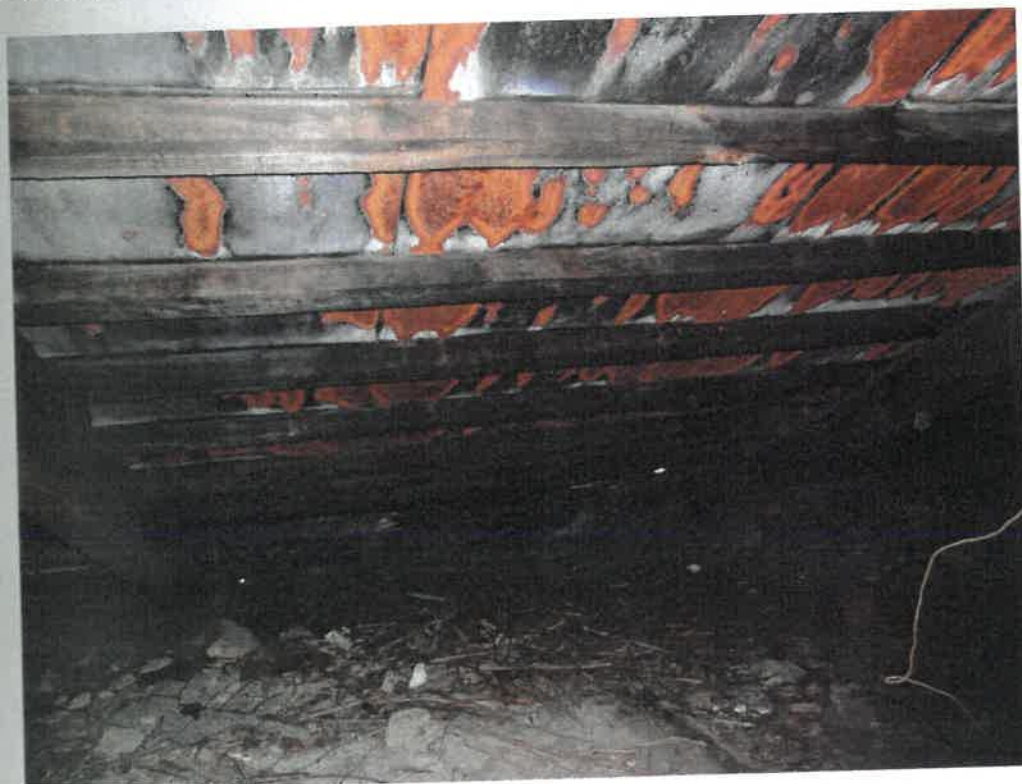
Skorodowane elementy dachowe.
