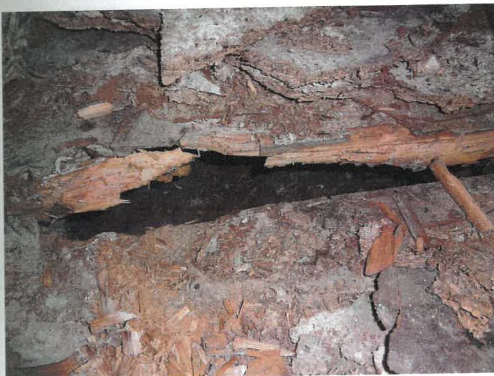
Odkrywka stropu pomieszczenia nr 8 zgnite i porażone przez grzyby elementy stropu.
