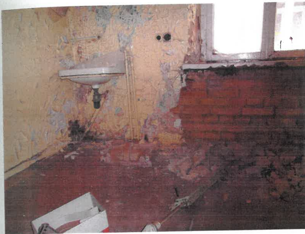
Zawilgocona i zagrzybiona ściana parteru pomieszczenia nr 2.
