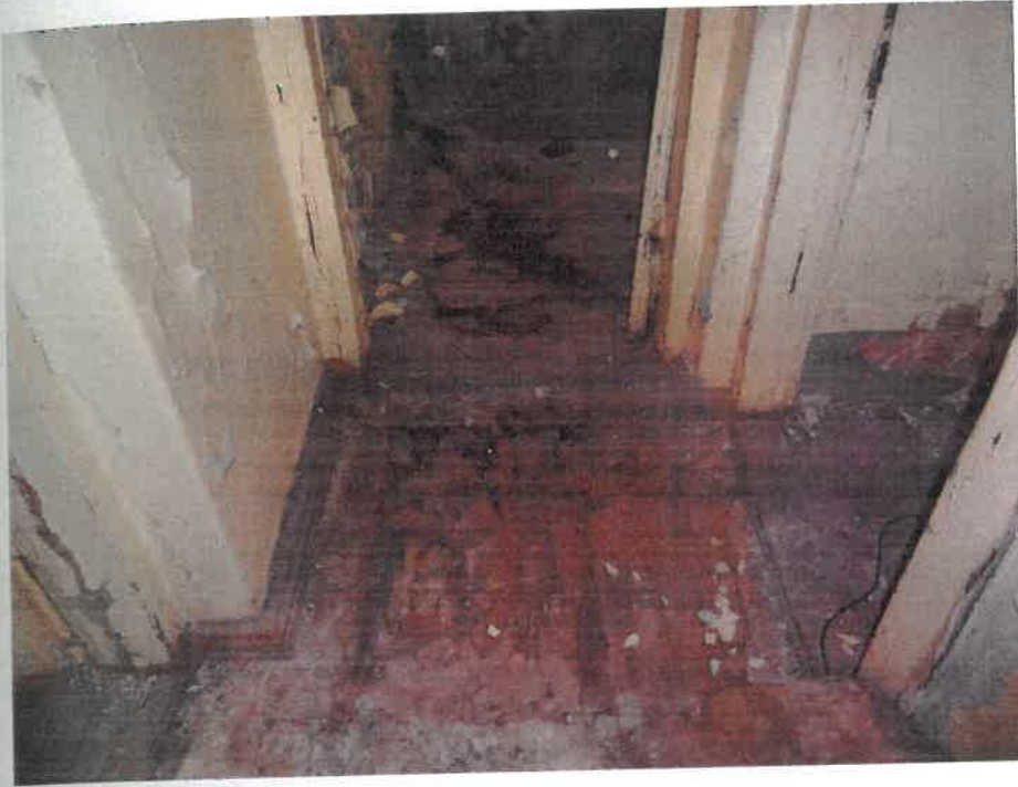
Skorodowane (zgnite) podłogi korytarza parteru.
