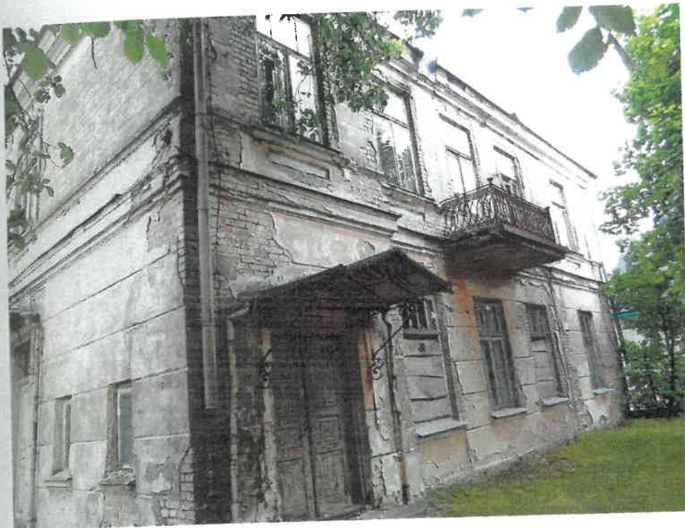
Elewacja północna- widoczna korozja biologiczna ścian i stolarki okiennej i drzwiowej, balkon z uwagi na niedostatecznie zakotwione belki wspornikowe środkowe w ścianie nie może być użytkowany i wymaga zabezpieczenia np. za pomocą stemplowania.
