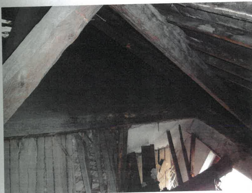
Zawalony strop nad pomieszczeniem nr 10.
