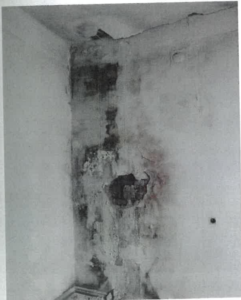
Pomieszczenie nr 11- zacieki z dachu, korozja ściany.
