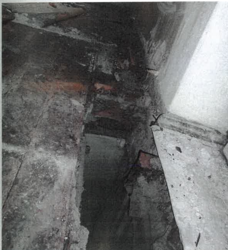
Odkrywka stropu nad parterem w pomieszczeniu nr 14- zgnite końcówki belek stropowych, przy ścianie balkonowej, widoczne niedostatecznie zakotwione w ścianie belki wspornikowe środkowe balkonu.
