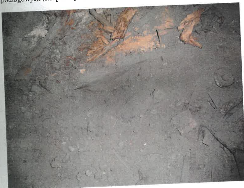
Porażone przez grzyby i owady belki stropu nad piętrem (poddasze).
